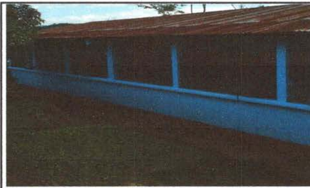
Foto 6: canales y bajada de agua pluvial
