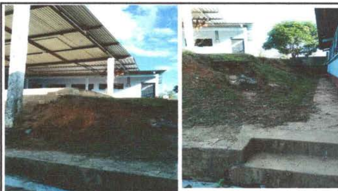
Foto 4: modulo 3 necesita muro perimetral
