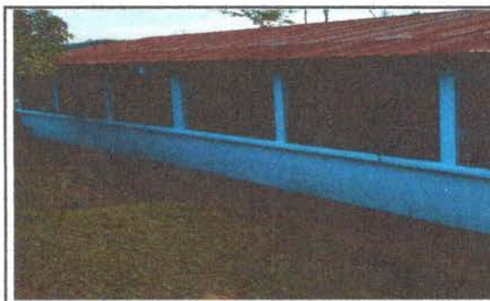
Foto 6: canales y bajada de agua pluvial
