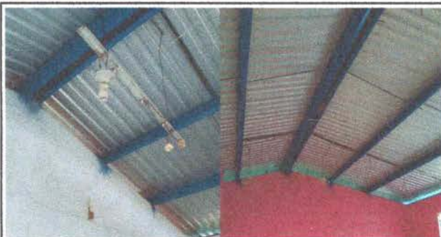
Foto 1: se observa que las aulas no poseen energía eléctrica
